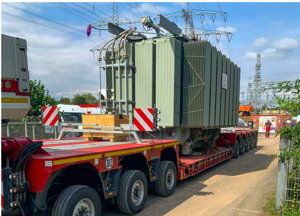
Bedeutende Investition für mehr Netzstabilität: Umzug des Großtrafos vom UW Dörnigheim in das UW Nord.
