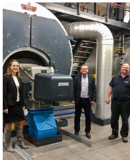
Neue Brenner im Heizwerk und Photovoltaik auf dem Dach verbessern deutlich die CO 2 -Bilanz von Wolfgang I.
