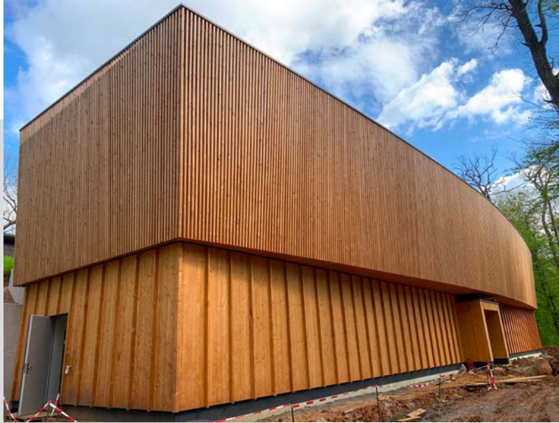
Das neue Wasserwerk in Wilhelmsbad hat im Juni 2023 die Arbeit des benachbarten alten Werks übernommen. Bis 2024 soll auch die neue Trinkwasseraufbereitung die alte ablösen.
